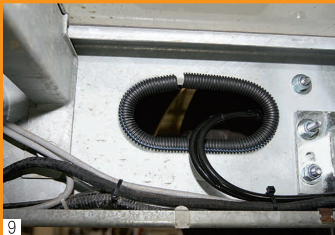
9. Rien n'est laissé au hasard. Les parties saillantes en contact avec les flexibles sont protégées par un cordon en plastique.
